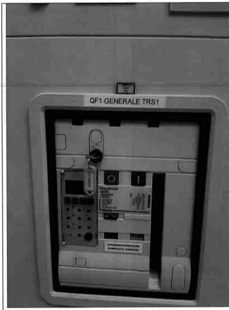
Quadro elettrico generale Magazzino 27
