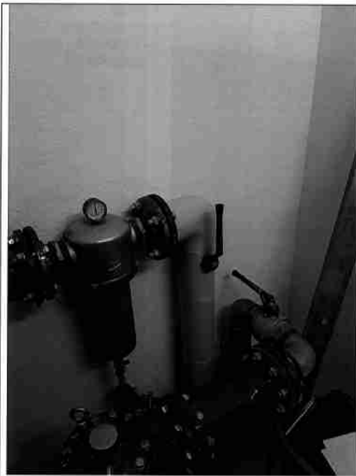
Valvole di intercettazione dell'impianto idrico del Magazzino 27
