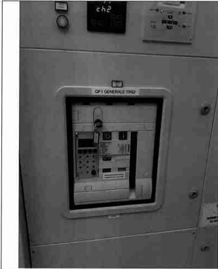
Quadro elettrico generale Magazzino 28
